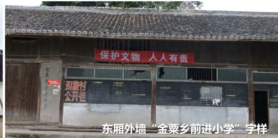
房屋漏雨严重，墙体部分改为砖砌
